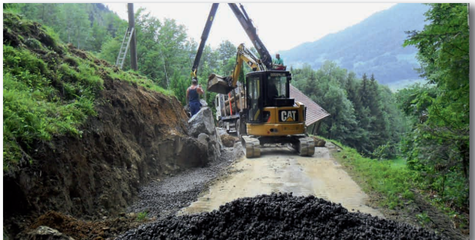
Wie hier oberhalb der Dächmen wird die Morgartenbergstrasse an einigen Stellen leicht verbreitert und wo nötig begradigt.
